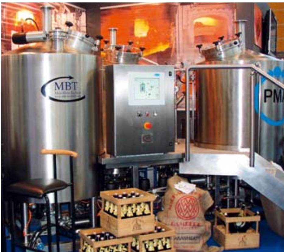
Die komplette Brauanlage steuert, regelt und überwacht die VarioPLC-Steuerung
